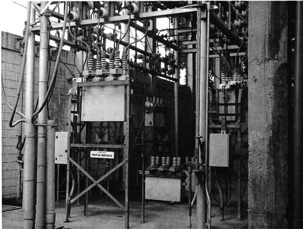
Gráfico 2-1.- Reconectores de la subestación Boyacá
