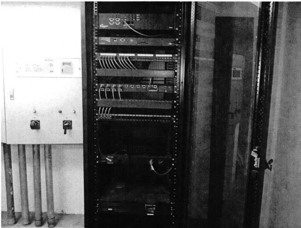
Foto #2: Armario de los equipos instalados en cada subestación, los cuales en conjunto se encargan de la transmisión de datos técnicos de los equipos eléctricos de la subestación, al sistema de automatización SCADA.
