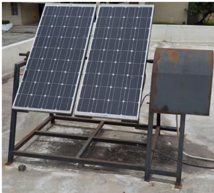
Figura 22 Paneles solares en CIDIS
