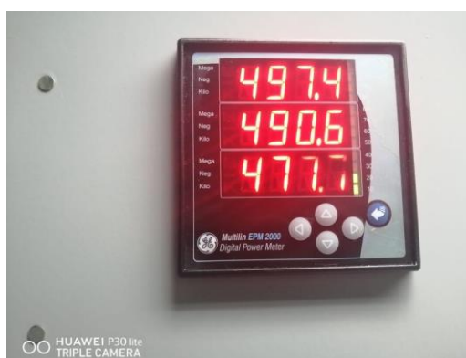
Figura 1.6. Medidor de Energía EPM2000
