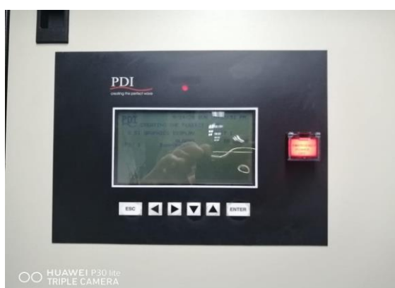
Figura 1.9 Pantalla tablero de distribución inteligente
