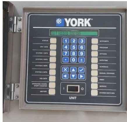
Figura 1.13 Interfaz de Control Chiller
