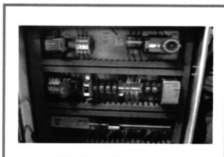
Fig. 30 Cableado de todo el tablero eléctrico.
