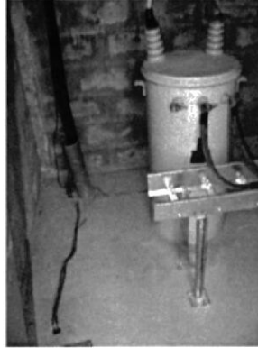
Figura 5.9 Banco de transformadores 3x50 KVA Sección Oficinas-Balanza
