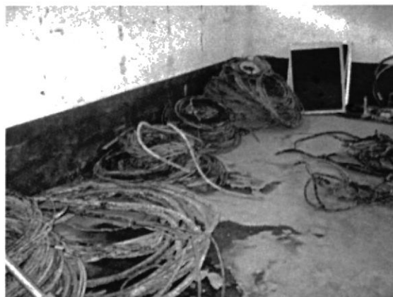
Figura 3.8 Tabla de Material Eléctrico bloque 1 y material eléctrico en bodega
