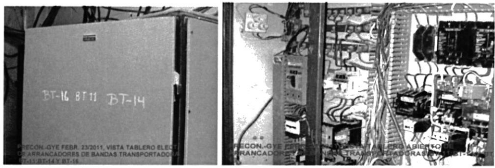
Figura 2.9 Tablero de bandas Transportadoras
