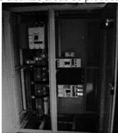
Figura 6.4 Tablero de Distribución Principal Sección Secundaria-Terciaria
