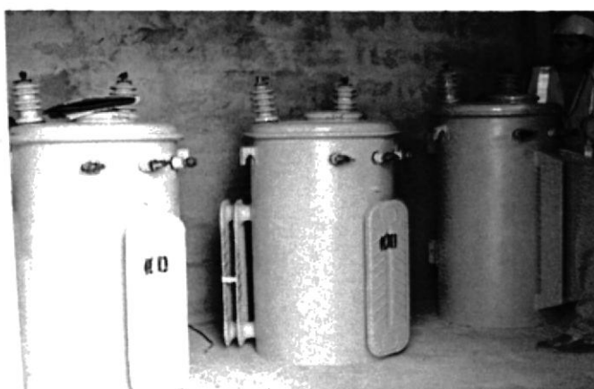
Figura 3.7 Banco Transformadores Primaria 3x100 KVA
