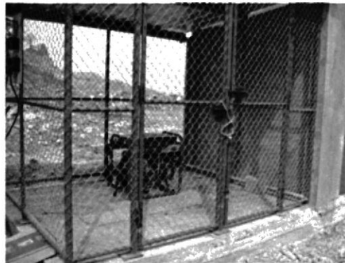
Figura 4.6 Cuarto de Generador Eléctrico
