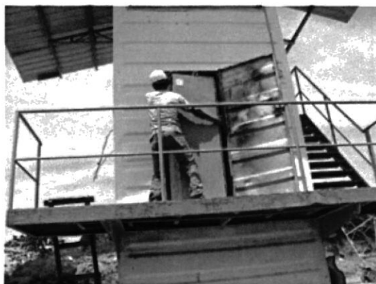
Figura 6.7 Tablero de arrancadores Sección Secundaria-Terciaria
