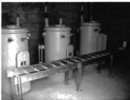
Figura 5.8 Banco de Transformadores 3x100 KVA Sección Primaria
