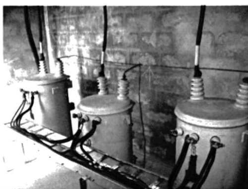
Figura 5.5 Banco de transformadores 3x50 KVA
