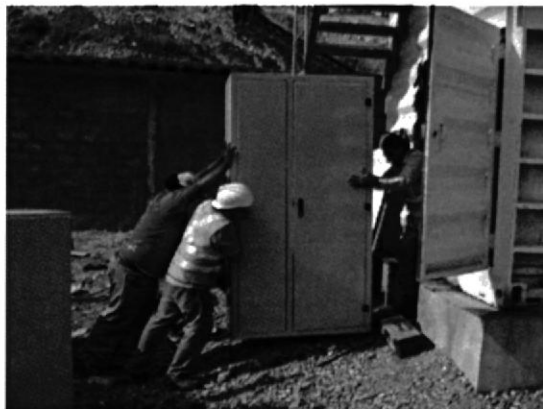
Figura 6.5 Tablero de Distribución Sección Secundaria-Terciaria
