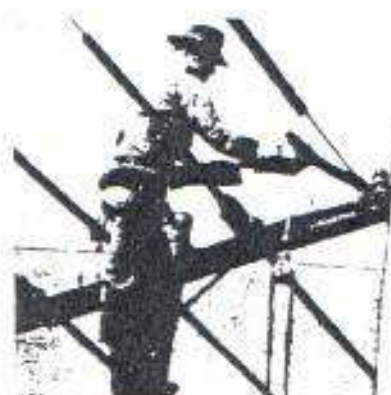
Fig. 6.10. Cobertores de líneas.
