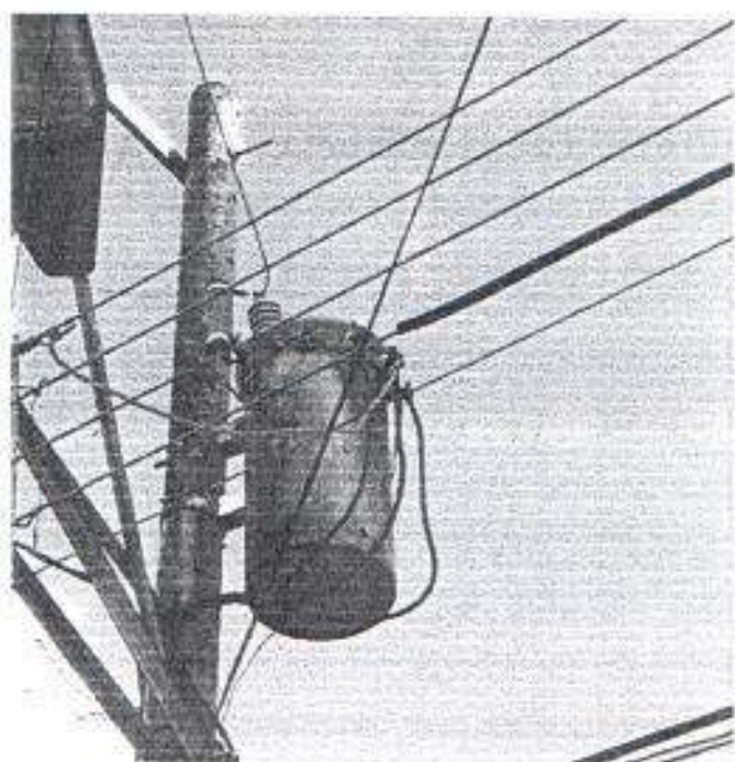
Fig. 2.32. Transformador # 621, con su carcasa oxidada.
