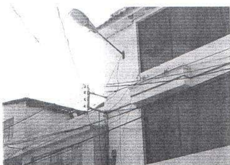
Fig. 2.6. Poste muy pegado a una vivienda.
