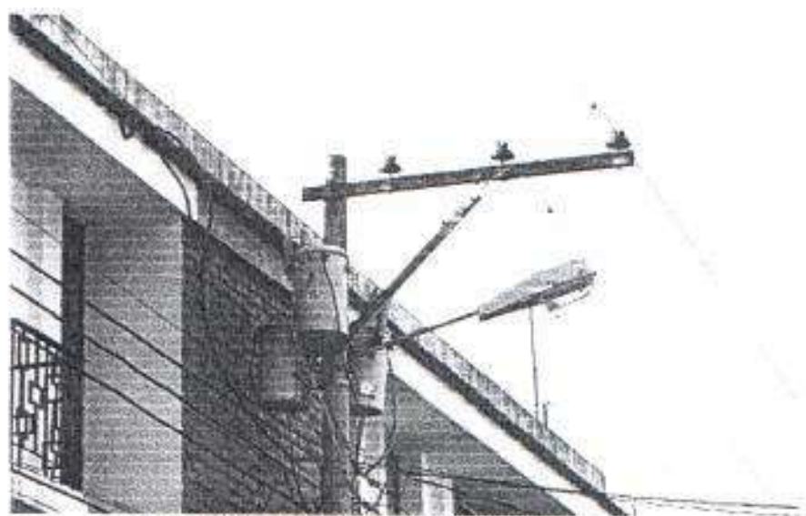
Fig. 2.25. Banco de transformadores.
