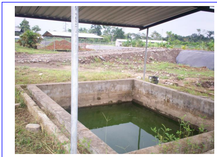
Fig.3.21 Piscina de cemento receptora de lixiviados provenientes de la Unidad de Landfarming.; tomada en el Cañón de los Monos-Coca, Cristina Ballesteros, febrero del 2007.
