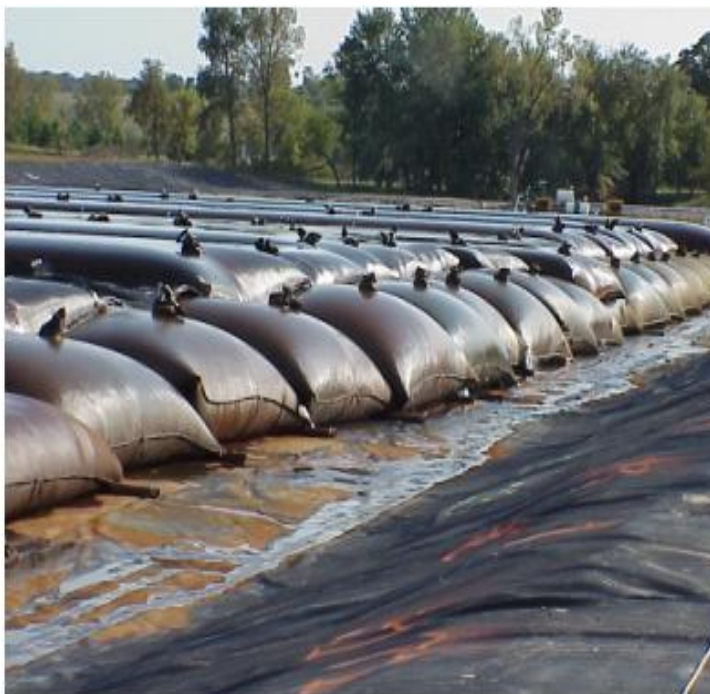
Fig. 4.1 Geotubos de Tratamiento, fuente Internet, mayo 2007
