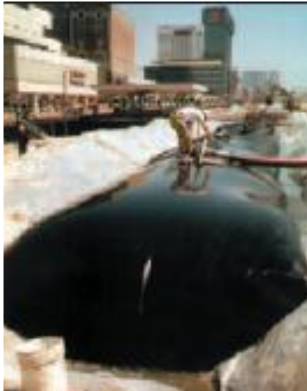
Fig. 4.2 Geotubo, fuente Internet, mayo 2007
