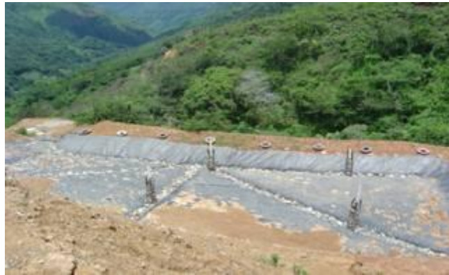
Celda de los Residuos Sólidos: Geomembrana, chimeneas y drenes interiores.
