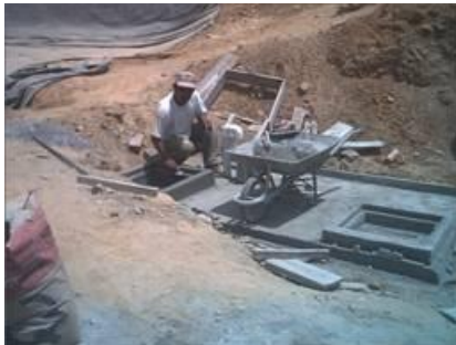
Fosa Séptica de las Celdas de residuos sólidos del Relleno Sanitario
