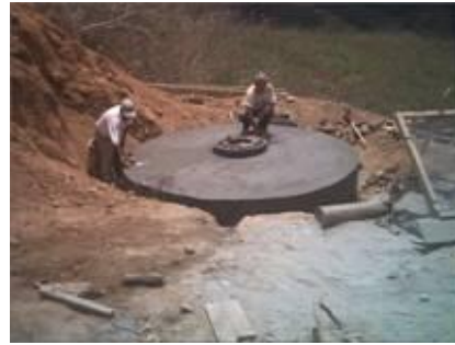
Pozo de Absorción de las Celdas de residuos sólidos del relleno sanitario.
