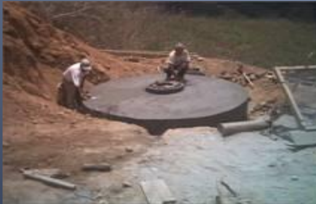
Pozo de Absorción de las Celdas de residuos sólidos del relleno sanitario.
