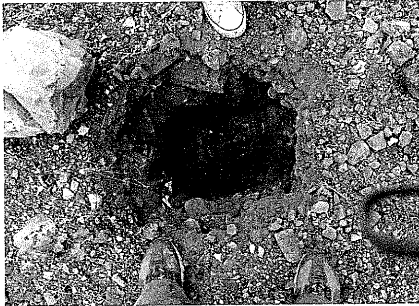
Figura 5.5.2 Toma de muestra de material granular para los espaldones, área de terrazas para construcción del PARCON-ESPOL.
