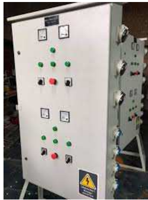
Figura 35 Tablero de Distribución
