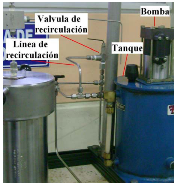
Fig. 3.13 Línea y válvula de recirculación (Fuente: Colón López, Octubre 2007)
