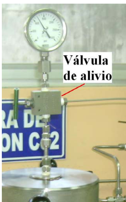
Fig. 3.17 Válvula de alivio instalada sobre la tapa de la cámara
