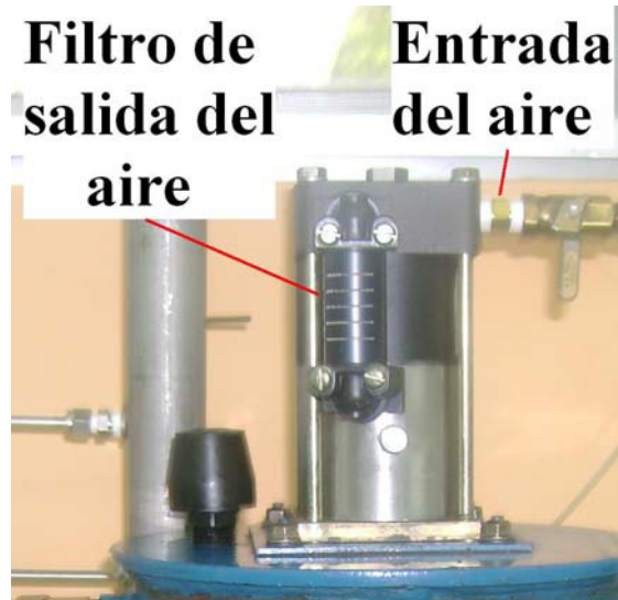
Fig. 3.25 Entrada y salida de aire de la bomba (Fuente Colón López, Septiembre 2007)
