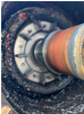
Fig. 4. Motor del Fabricante Wolong 10 HP, 4 pares de polos con fallo en los rodamientos producido por un falta de mantenimiento preventivo.
