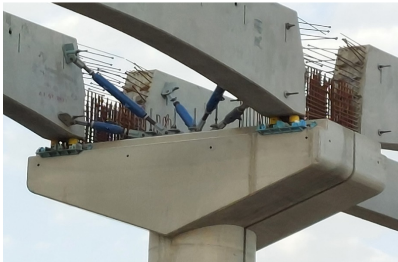
Figura 62 Gatos hidráulicos para ajuste viga para monorriel.
