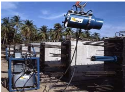
Figura 35 Imagen representativa de unidad de bombeo tipo E.
