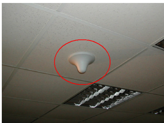
Figura 3.10 Antena omnidireccional montada en el cielo falso
