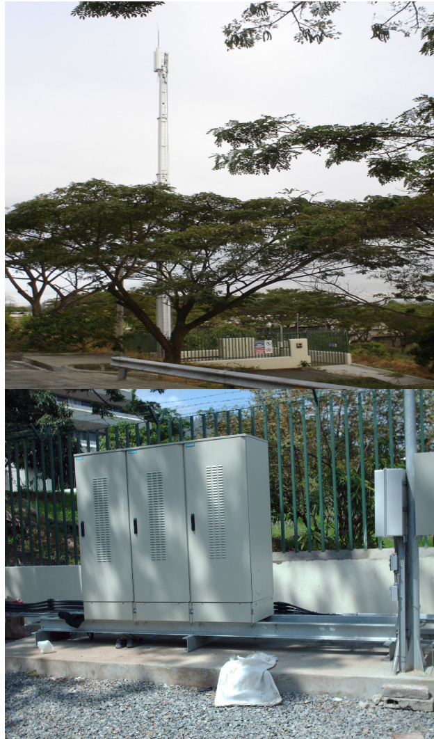
Figura 1.13 Estación base GSM (ESPOL)
