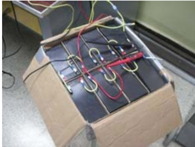
Figura 5 Banco de Baterías
