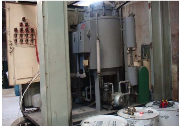
FIGURA 3.3 EQUIPO FILTRADOR DE ACEITE PARA LOS TRANSFORMADORES
