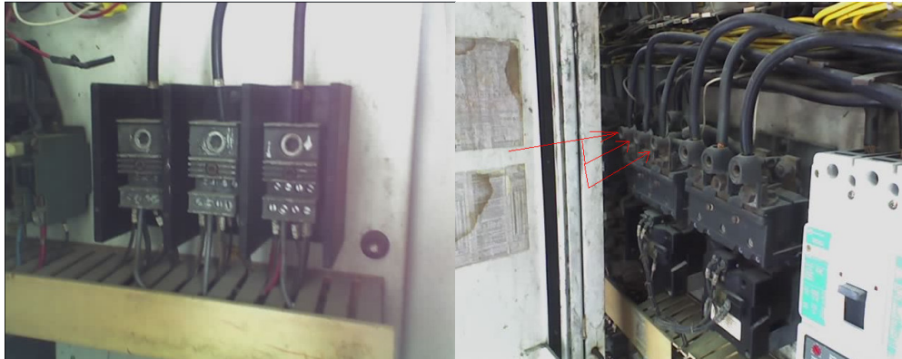
Figura 4.5. Partes energizadas sin el aislamiento requerido.
