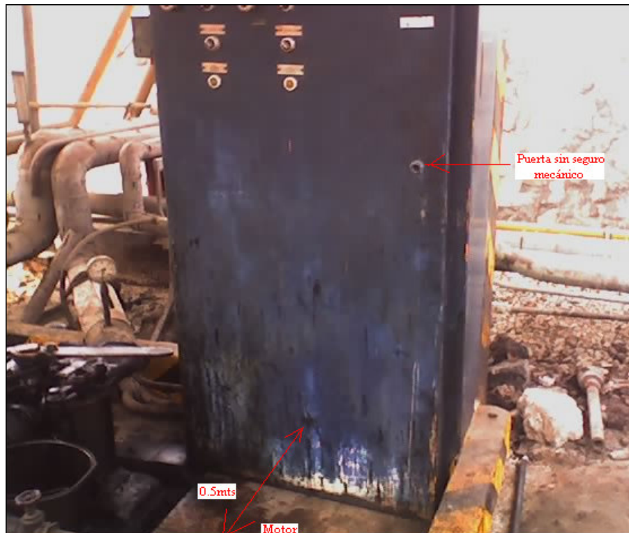
Figura 4.1. Estado físico del panel de bombas de combustible.
