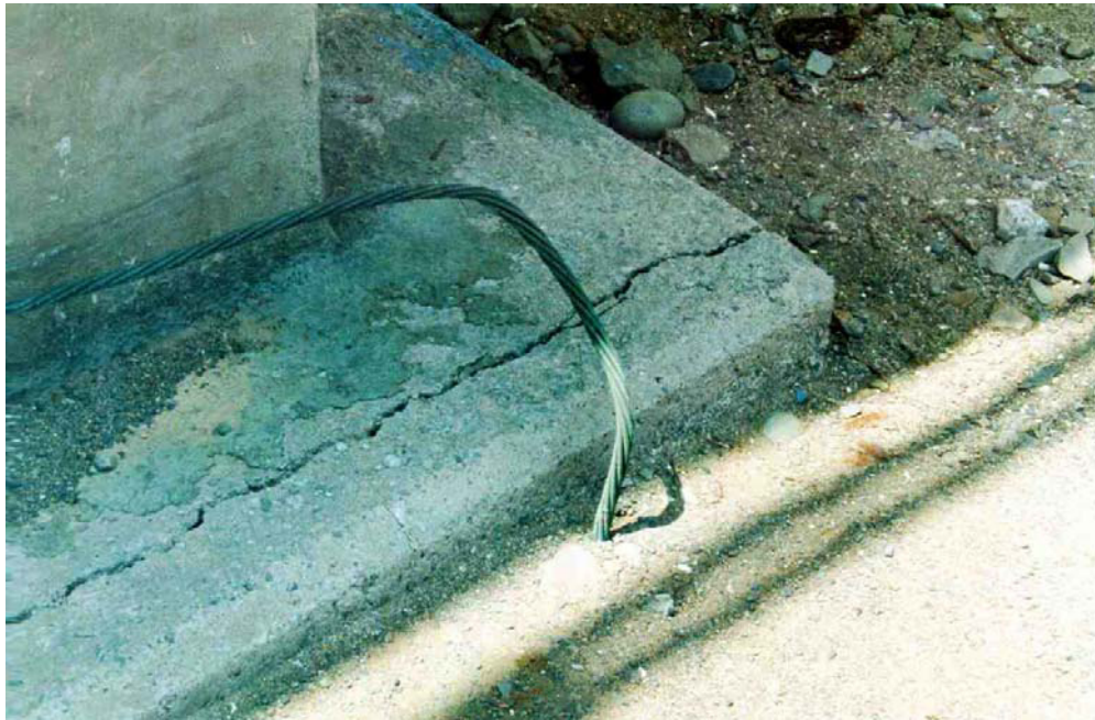
Fotografía 3. Fisura por corrosión de la armadura.
