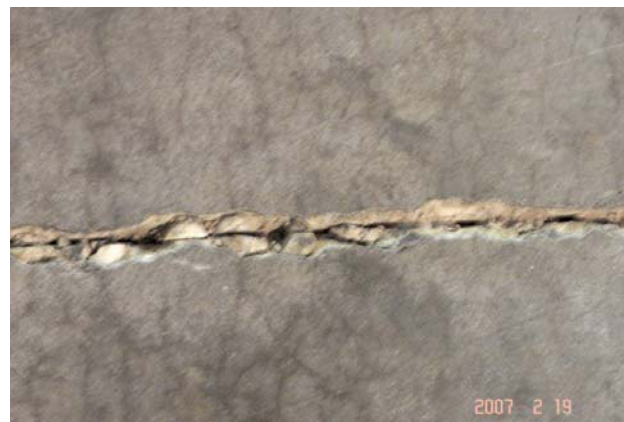
Fotografía 8. Fisura en la Junta de Contracción.
