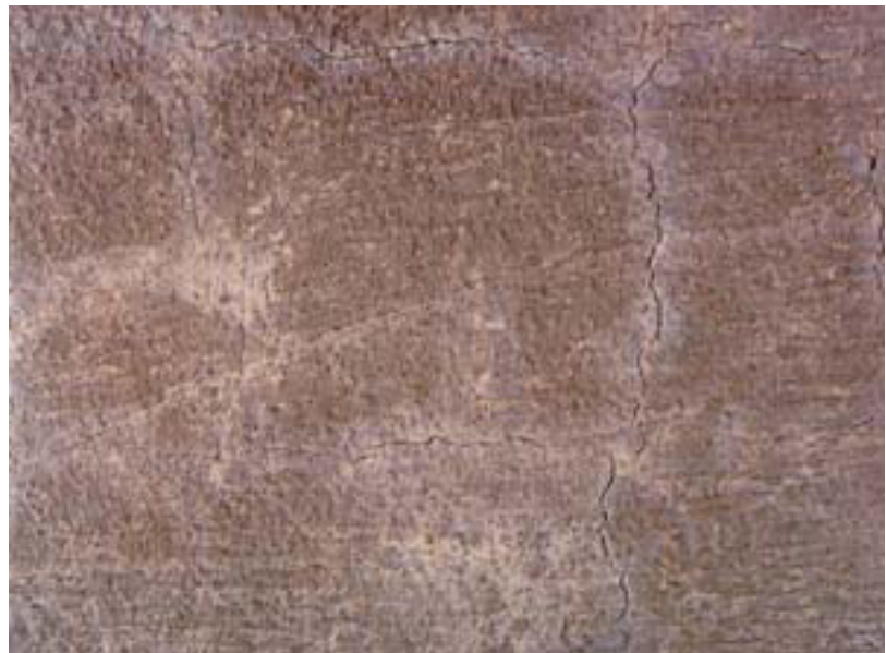
Fotografía 6. Fisura de afogado (fisuras en mapa)
