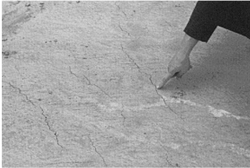
Fotografía 5. Fisura en una losa por retracción plástica
