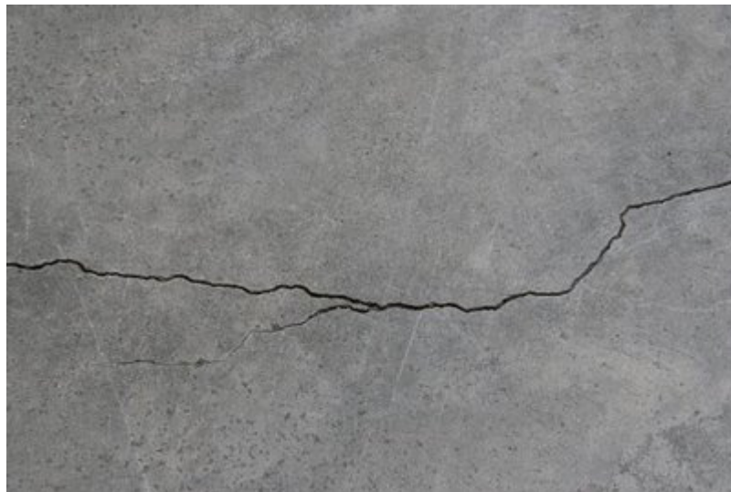
Fotografía 1. Grieta en una losa de hormigón
