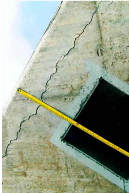
Fotografía 2. Fisura por corrosión de la armadura.
