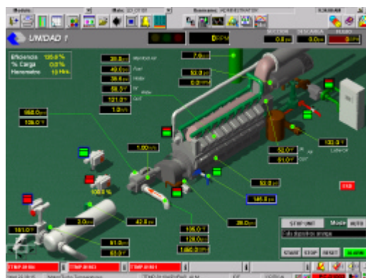
Fig. 3 .- Despliegue de la Unidad de Bombeo
