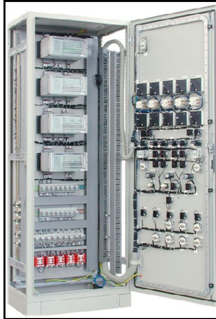
Figura 3.34 – Tablero de Distribución [18]
