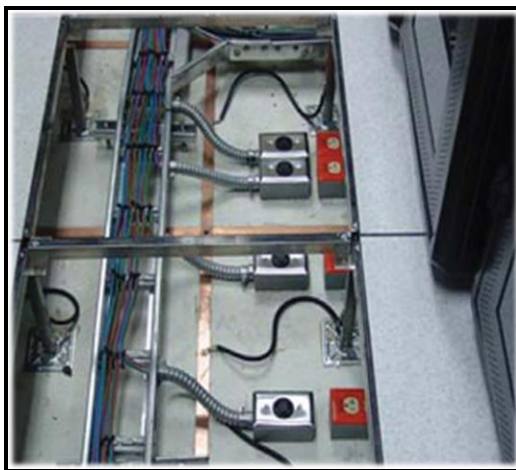
Figura 3.37 – Cableado Eléctrico bajo Piso Falso
