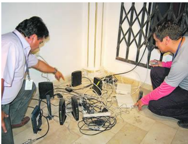
Figura 1.5: Sistema Bypass detectado en un sector de la ciudad de Guayaquil.
