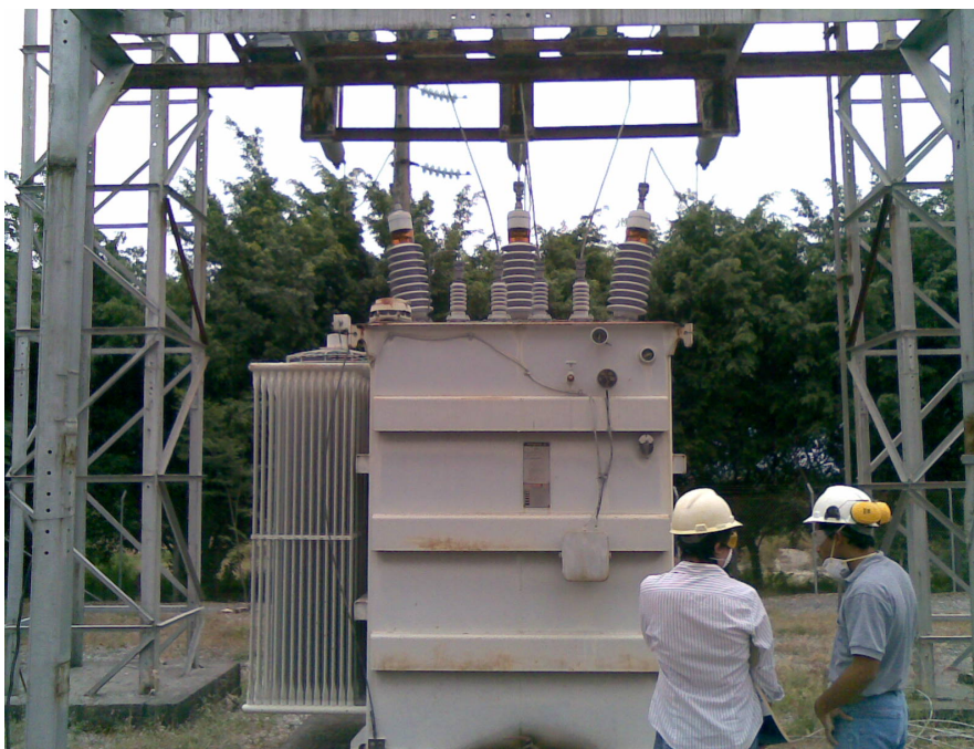
Figura #3. Subestación principal
